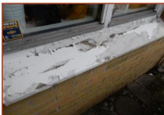
2. Färg på fönsterbleck flagnar.
