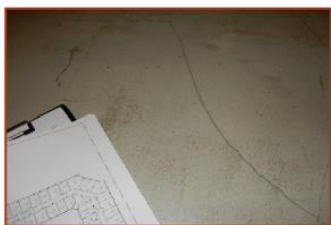
14. Spricka i källargolv
