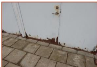
1. Förråd rostigt i nederkant.
