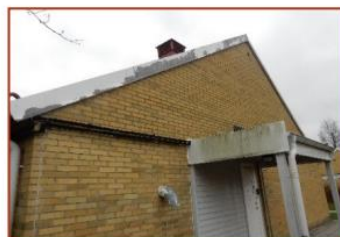
9. Färgen på plåtarbeten flagnar.
