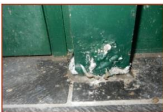
4. Nederkant entréparti skadat.
