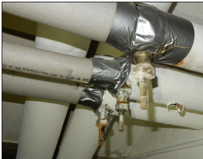
Ärgade och korrosionsskadade stamventiler
