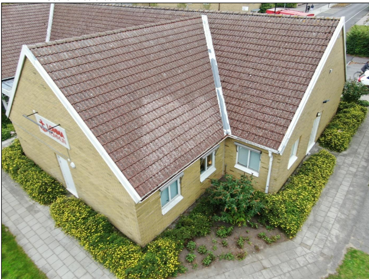
Vy över tak/fasad. Plåtbeslag med färgsläpp.
