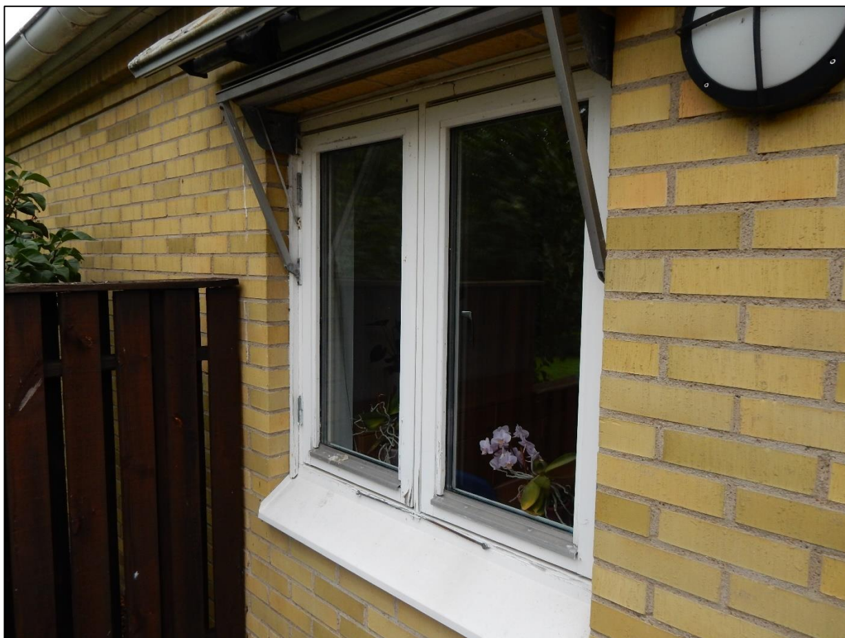
Fönster i behov av skrapning och målning
