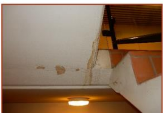
10. Sprickor vid infästning av trapplopp.
