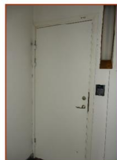
12. Sprickor på båda sidor om dörren.
