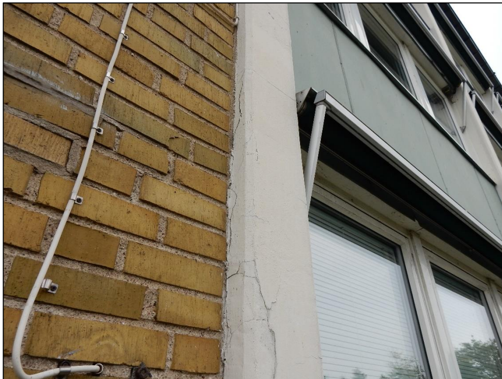
Skador i tegel- och betongfasad Vy över tak/fasad
