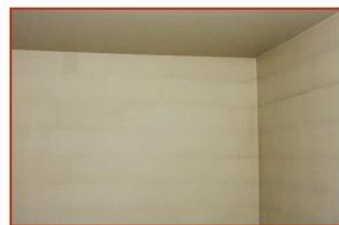
15. Fogarna från bakomliggande murning syns genom putsen i trapphuset.
