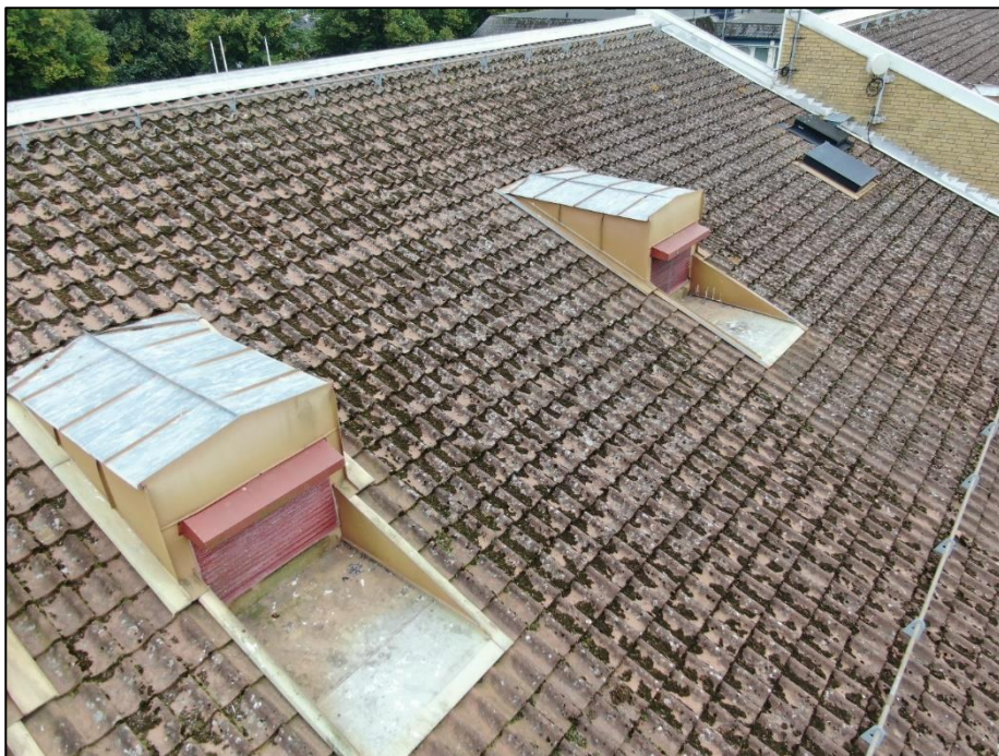
Takpannor med alger/mossa samt takkupor med färgsläpp
