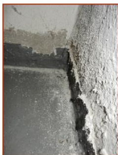
13. Fuktigt på källarväggar.
