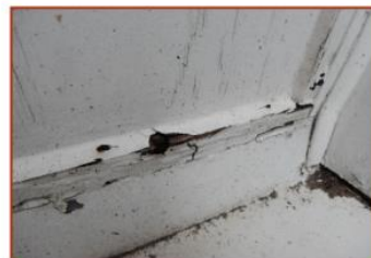
3. Panel under fönster murknar utvändigt.
