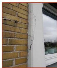
2. Färgen spricker på betongpelare.
