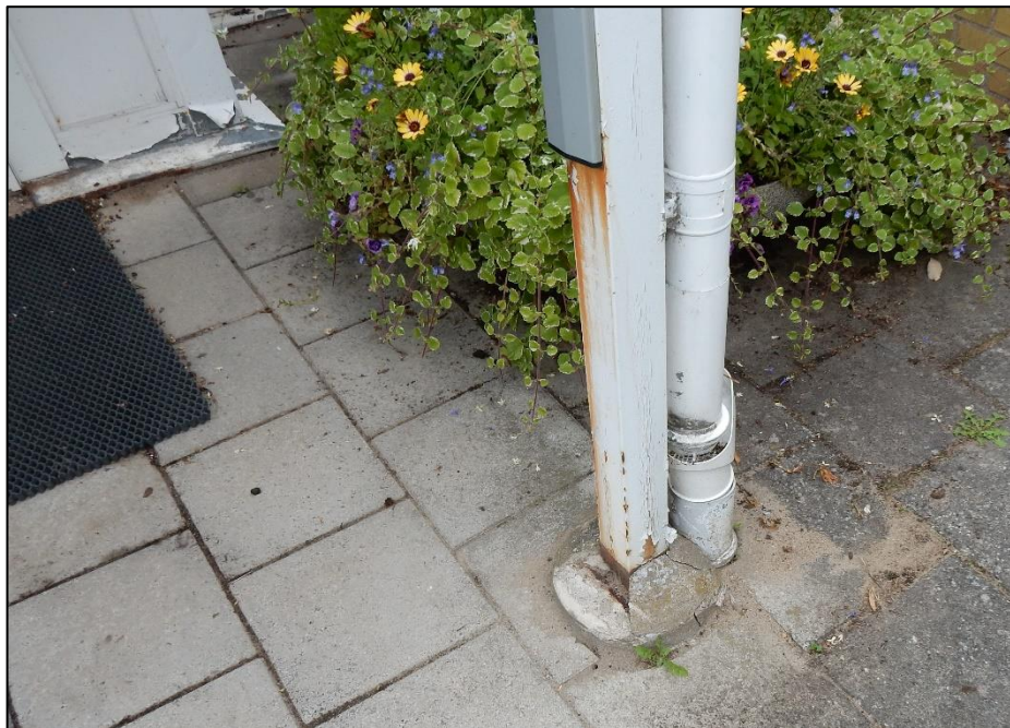
Skador i pelare tillhörande skärmtak innergård
